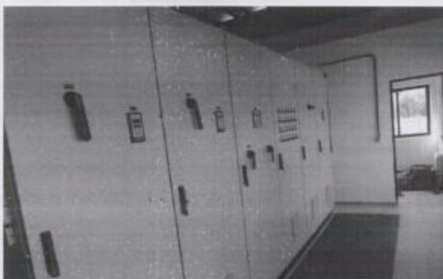
Foto 17- EEAT I – Painel de Potencia.
