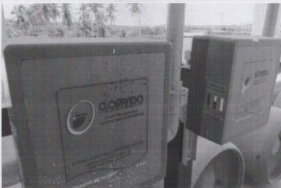
Foto 06- EDOS - Dosadores de cloro gás.
