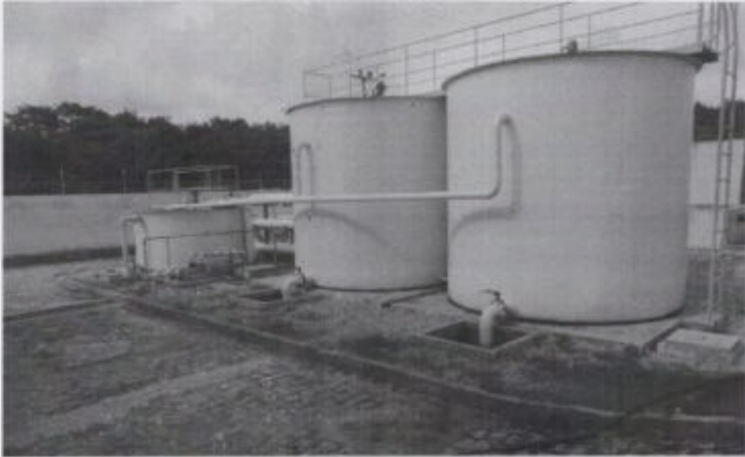
Foto 13- Sistema de descarte de lodo.
