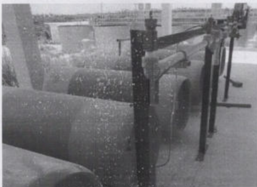
Foto 05 - EDOS - Manifolds de cloração.
