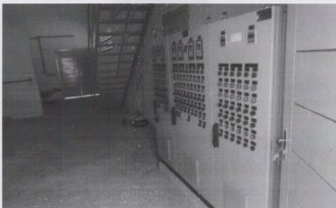
Foto 12- Painel de força ETRG.
