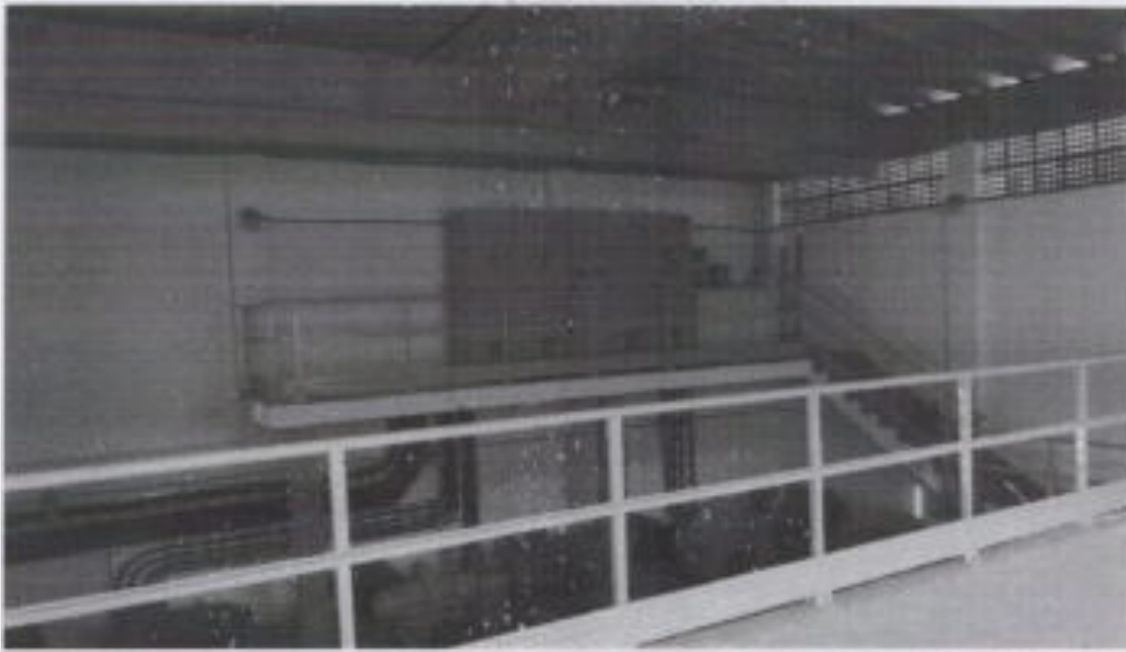
Foto 18- EEAT II - Conjuntos motobomba e Painel de Potência.
