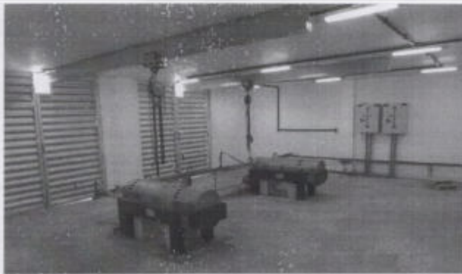
Foto 14- Sistema de desague de lodo.
