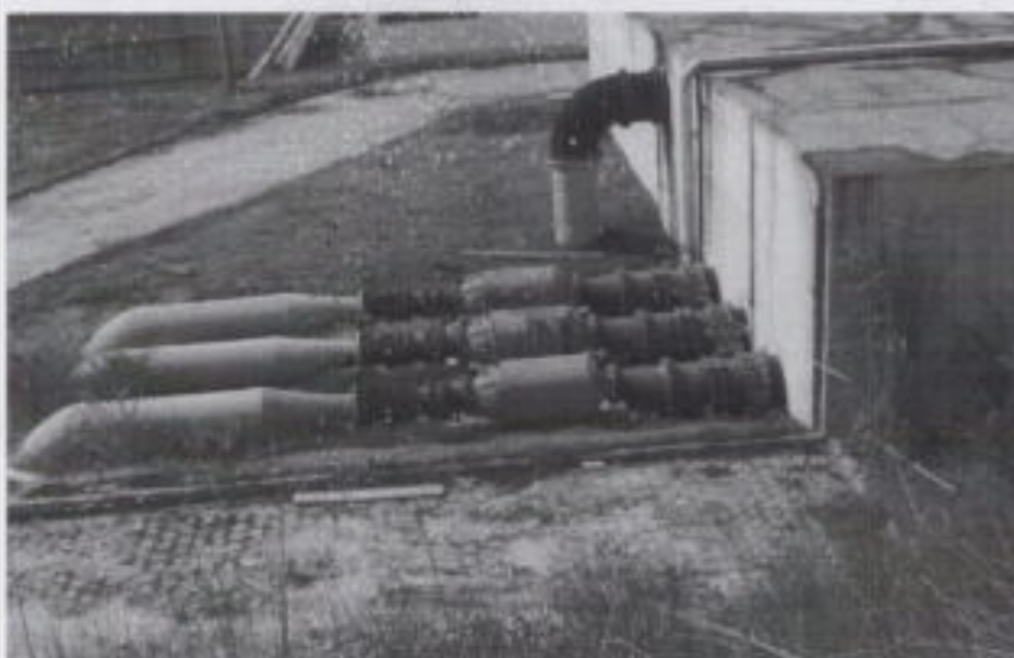
Foto 10- Bombas de Lavagem.
