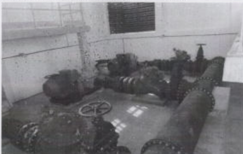
Foto 16- EEAT I – Conjuntos motor bombas.
