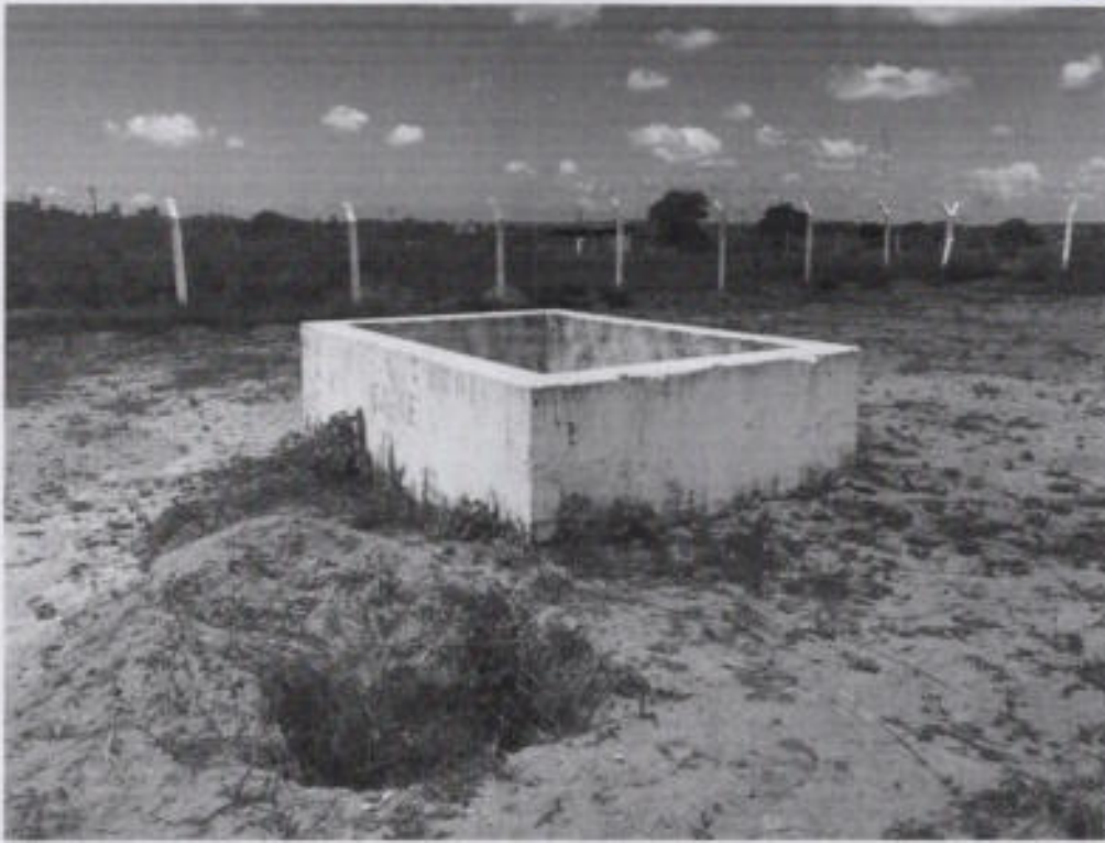
Foto 11 – Casa da Bomba
