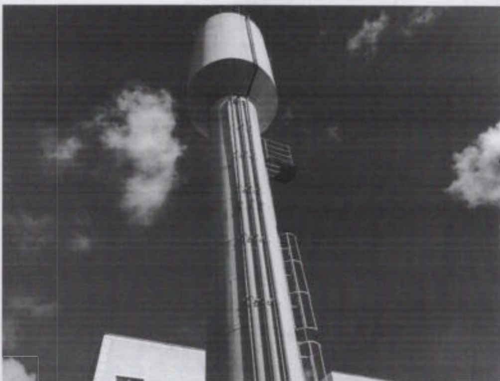
Foto 19 – Vista Frontal + Escada com Guarda Corpo OBS: parte da escada faltando
