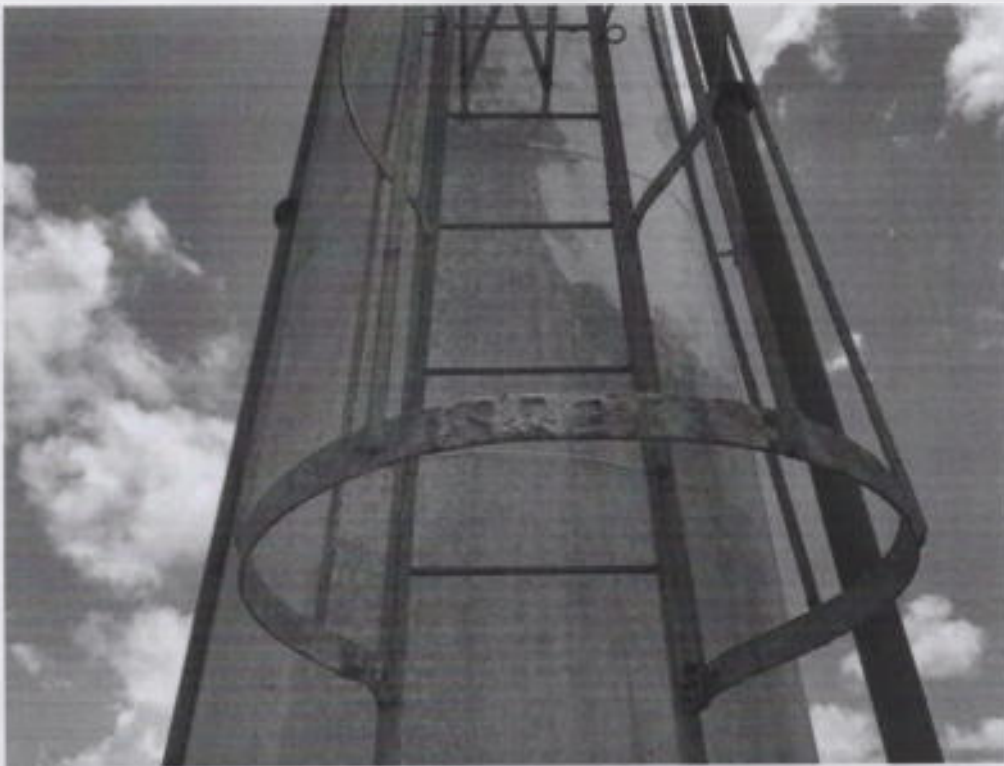
Foto 04 – Escada do Reservatório Oxidada
