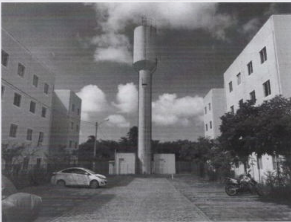
Foto 16 – Reservatório Elevado de Aço Tipo Taça de Coluna Seca N02 – RUA 05
